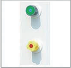
Control remoto de agua y gas
